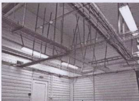
Instalatie electrica interioara,realizata pe paturi de cabluri
