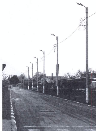
Retea de iluminat stradal
