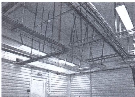
Instalatie electrica interioara,realizata pe paturi de cabluri
