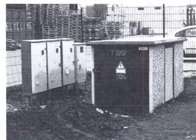
Post de transformare compact 400kVA
